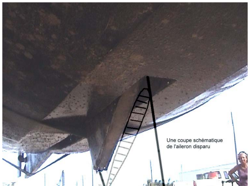
Le pivot, vu de l'avant, où était soudé l'aileron, dont on a schématisé une coupe. En fonctionnement normal le pivot est moins incliné et rentre presque entièrement dans la coque (voir le plan).
